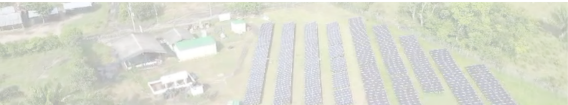
Area de Generación y Distribución.
